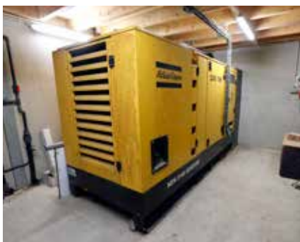
De plaatsing en aansluiting van het noodaggregaat zijn een schoolvoorbeeld. Het bedrijf heeft twee aggregaten.
